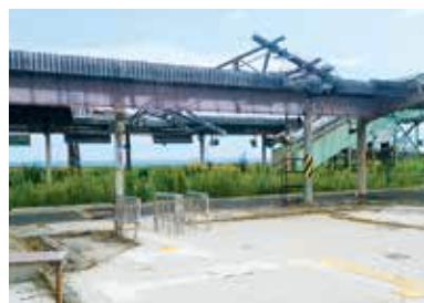
津波の被害により壊れたままの駅舎(JR富岡駅)。放射線量が高いため居住が制限された地域では復旧工事もほとんど進んでいない。(2013年9月撮影)
